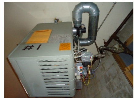
17. Unit Heater VENT
